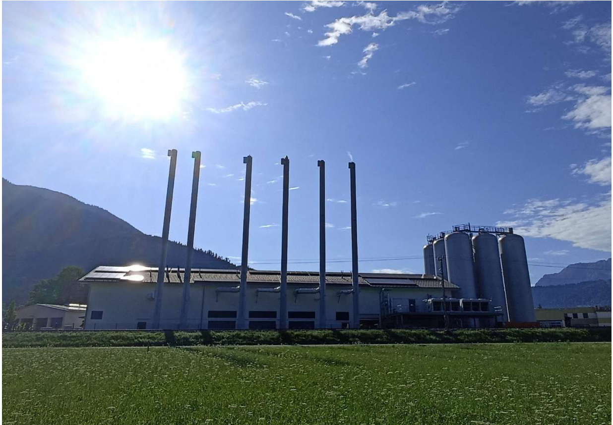
Blockheizkraftwerke und Wärmespeicher der Gemeindewerke
